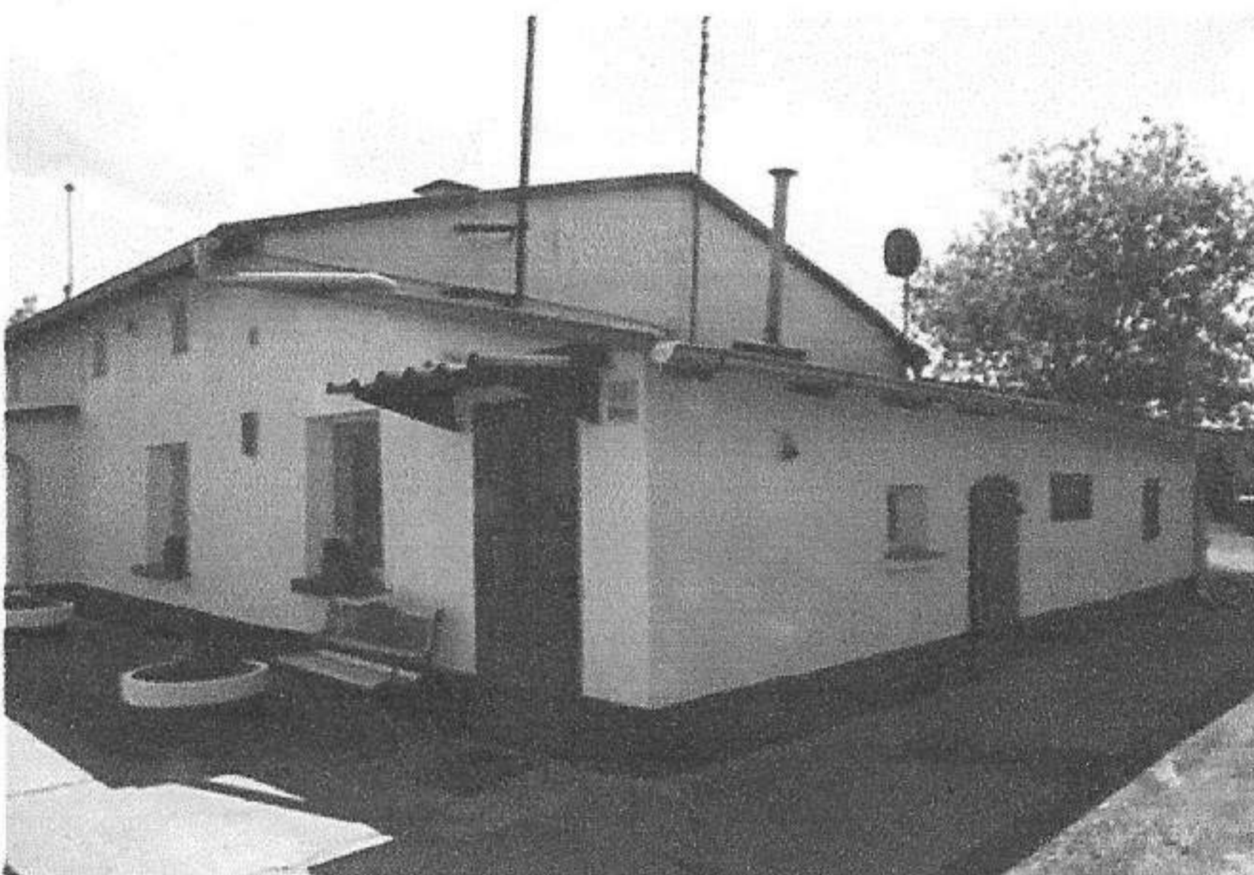
Rys. 17. Widok ścian budynku po 25 latach od zakończenia osuszenia systemem Hermon (fot. własna)
